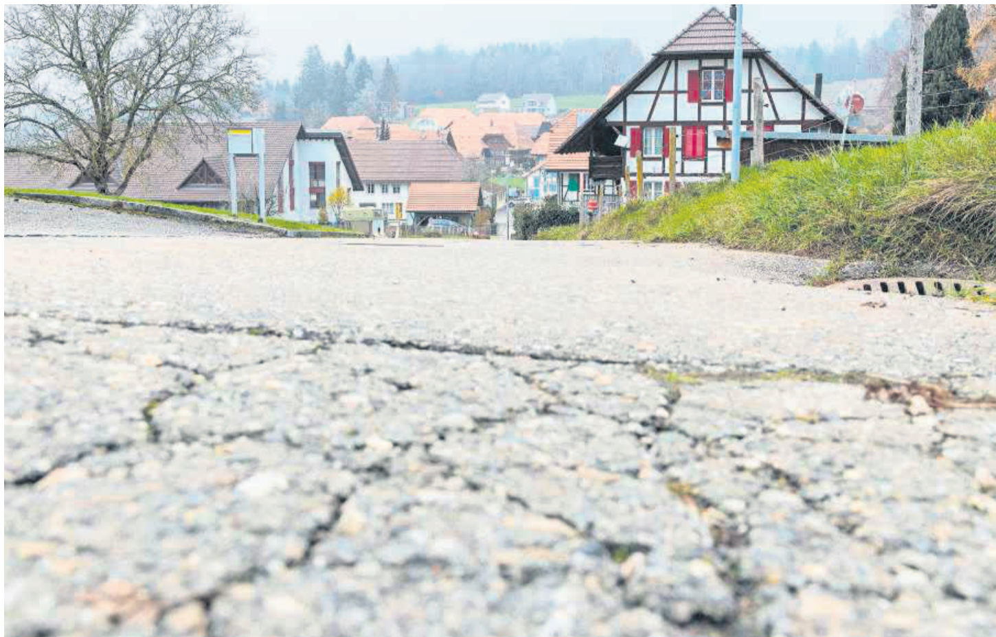
Der Zustand der Chätschgasse rechtfertigt längst eine Sanierung, so der Gemeinderat von Lüterswil-Gächliwil.
